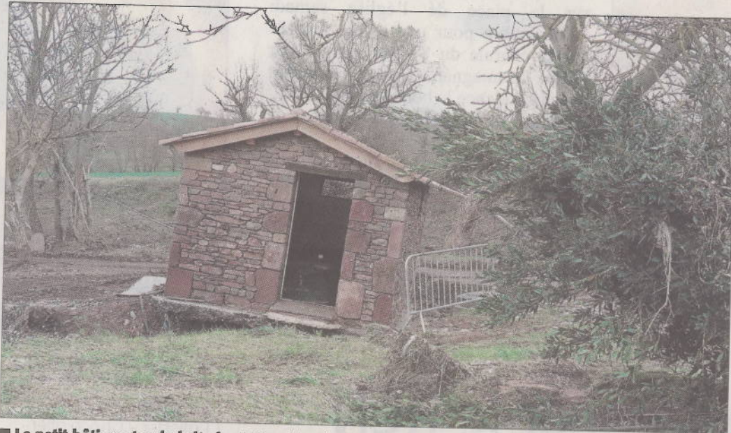
■ Le petit bâtiment qui abrite la station de relevage de l'assainissement a désormais un air penché.
